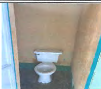
Foto 2: BAÑOS EN MAL ESTADO
