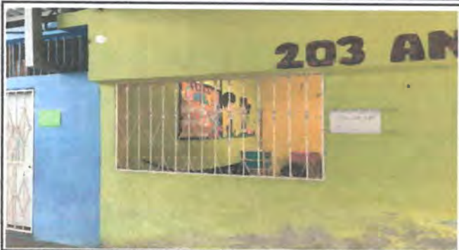
Foto1: VENTANAS EN MALAS CONDICIONES
